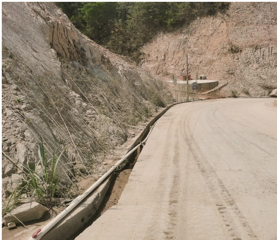
矿山道路排水沟
