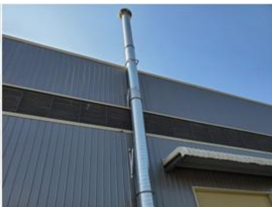
注塑废气排气筒
