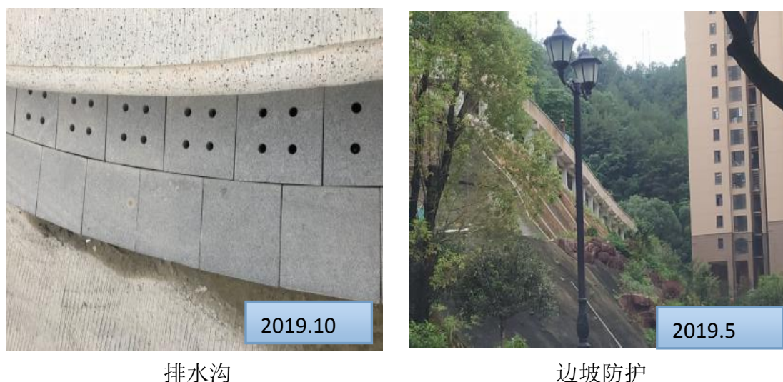
图 4-1 水土保持工程措施现状
