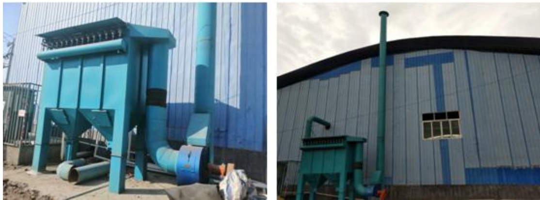
图 4.1-1 废气处理设施及其排气筒图
