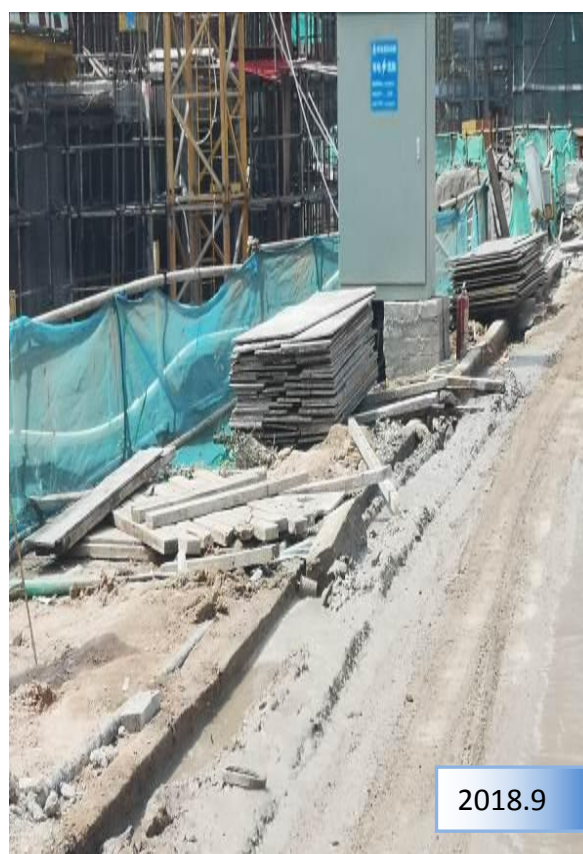
淤积的基坑排水沟
