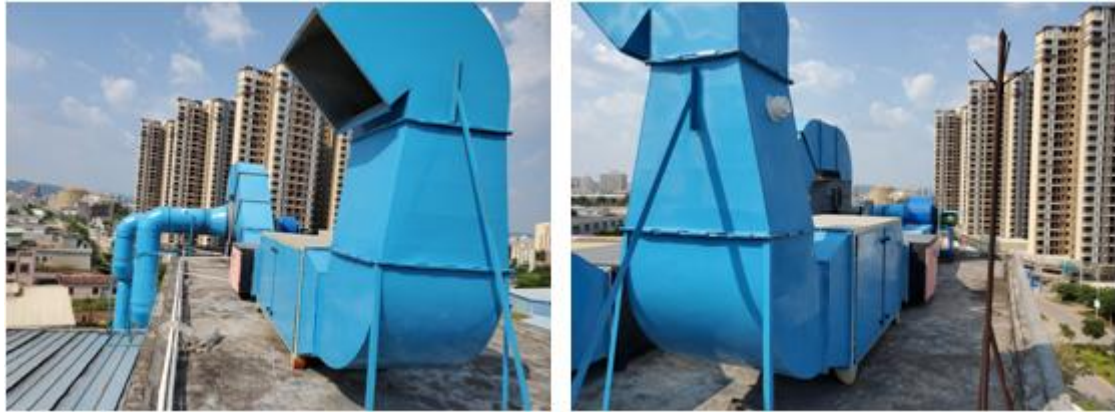
图 4.1-3 中底生产线有机废气处理设施及其排气筒图
