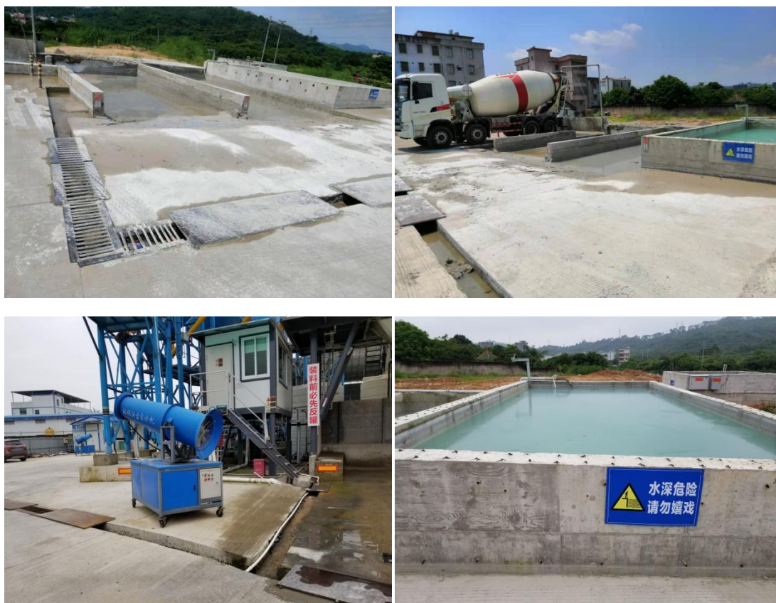
图 4.1-3 清洗废水收集沟渠及沉淀池图
