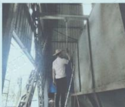
破碎废气采样口（处理后）
