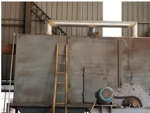
布袋除尘设施
