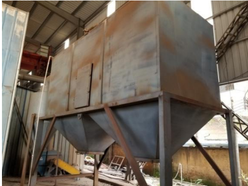
布袋除尘设施
