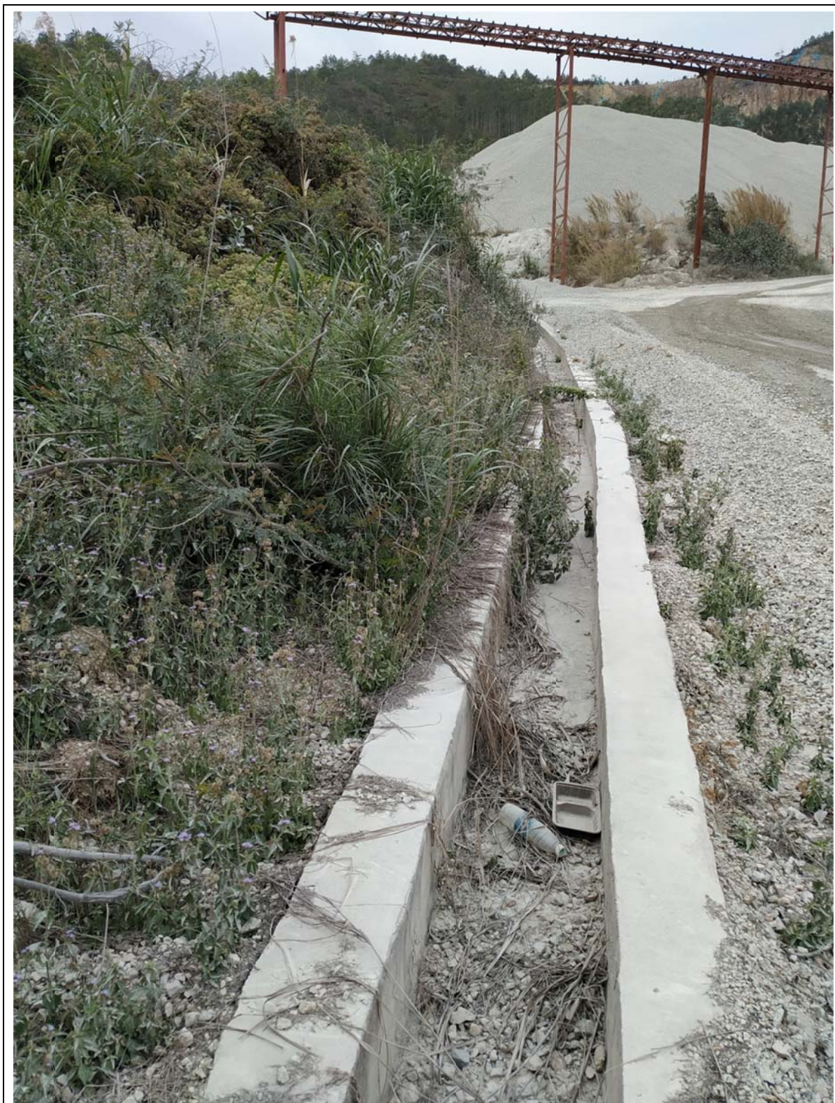
工业场地周边排水沟
