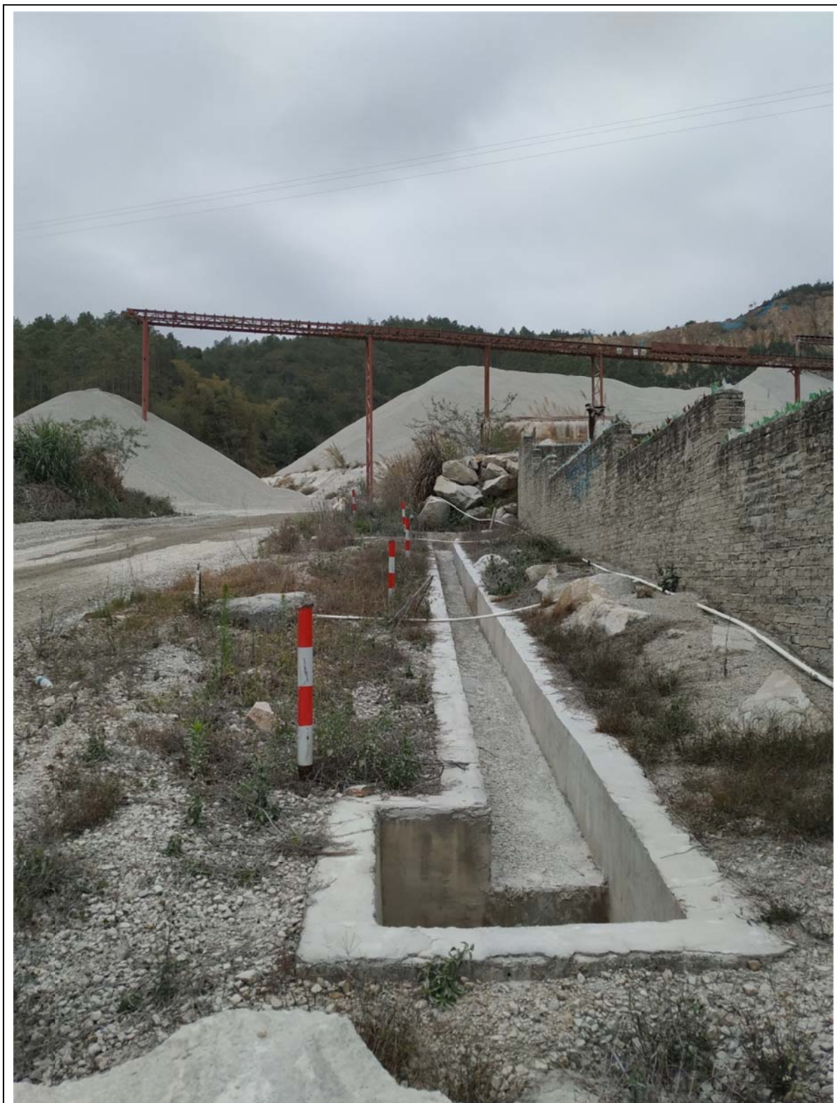
工业场地排水沟沉砂池
